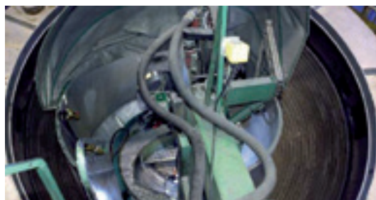
Расширительный бак парогенератора Soudotape 308 L Q5 + Record 8B308T1 Q5 Soudotape 309 L Q5 + Record 8B308T1 Q5
